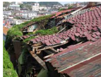
危険空き家の例
