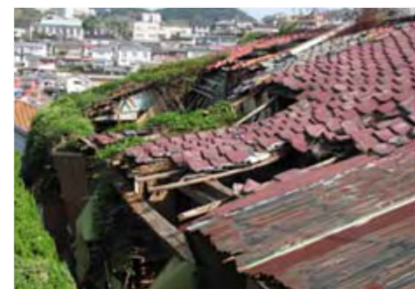
危険空き家の例
