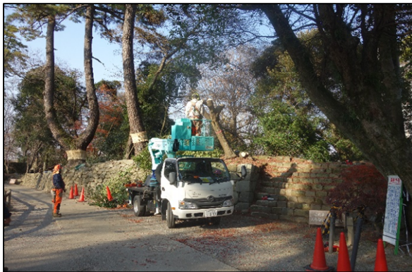
石垣を毀損する樹木の伐採
