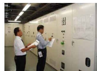
省エネルギー診断 (シビックセンター)
