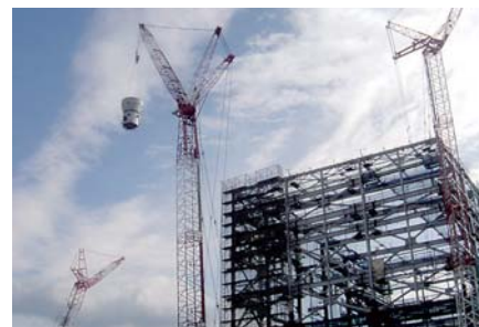
溶融炉取込状況
