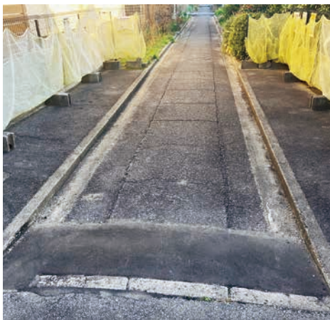
明大寺町の暗渠。戦前の地図の同じ位置には水路が示されている。
