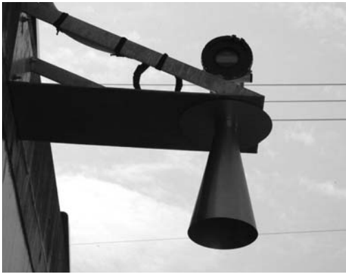
浸水警報装置
